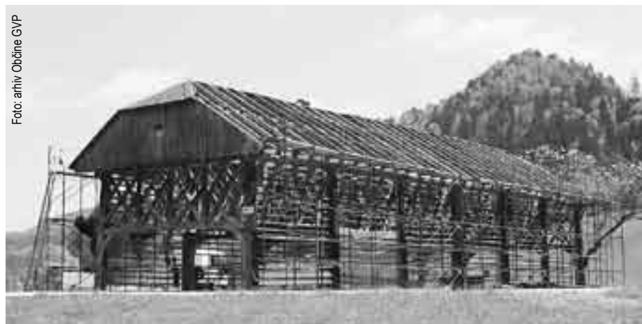
Posamezni strešni elementi na kozolcu so bili že tako dotrajani, da je bilo treba zamenjati celotno strešno konstrukcijo.
