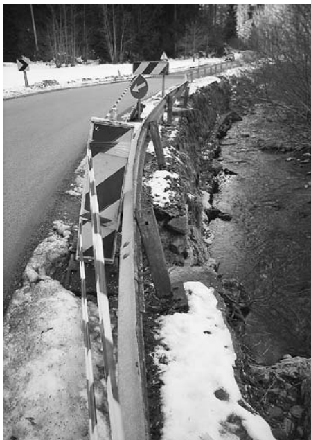
Ovinek pri Bucku že več let »krasijo« trakovi in znaki. Del varovalne ograje so kmalu po udoru bankine namestili bolj na cestišče in ga tako zožali; del ostaja ograjen.
