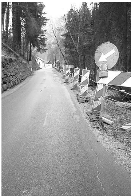
Pri Pajklcu je na že tako ozkem cestišču še dodatna ovira, in to ne tako nova: udor bankine, izpodjede, brez zaščitne ograje.
