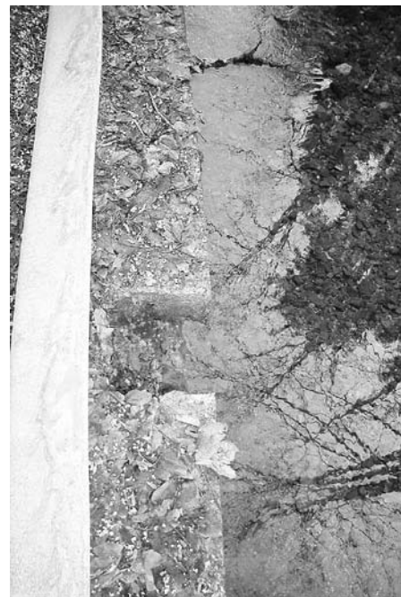
Le nekaj metrov naprej proti Pajklcu se je iz opornega zidu ob vodi odkrušil kamen. Poškodba trenutno voznikov še ne ovira.
