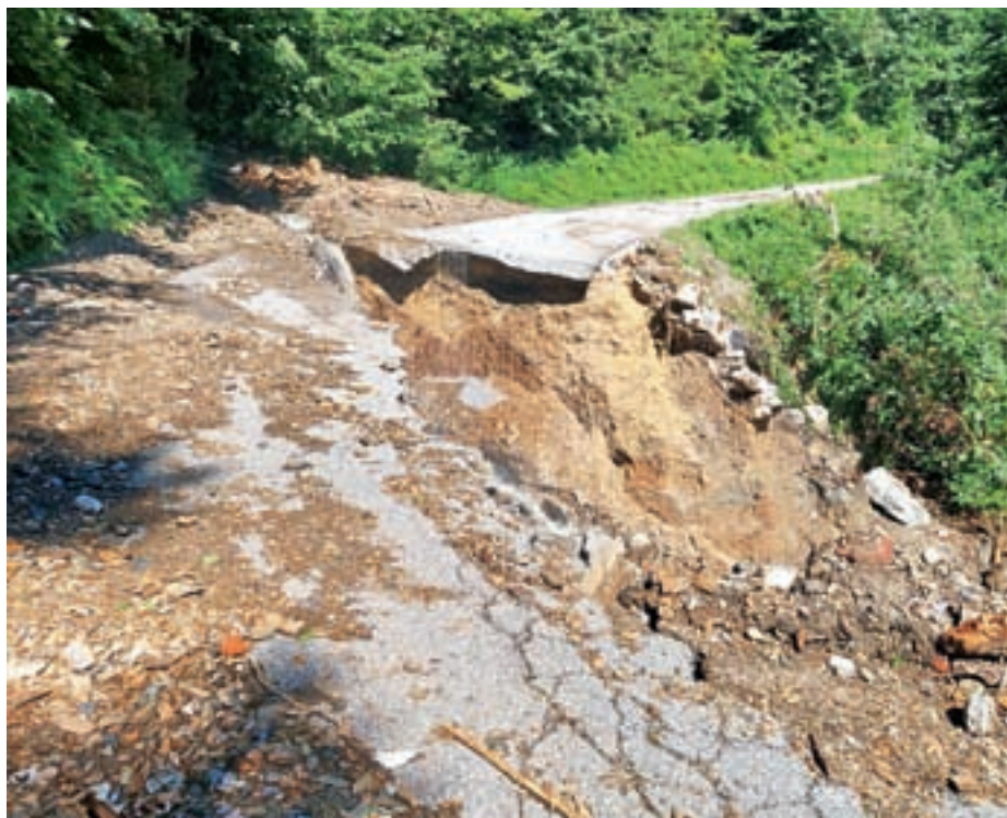
Plaz, ki je spodkopaval cesto iz Srednje vasi na Brda FOTO: ARHIV OBČINE
