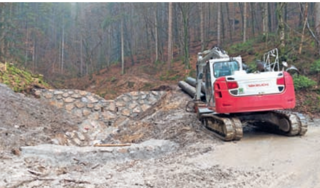
Ta čas v občini izvajajo štirinajst sanacijskih projektov. Na fotografiji sanacija hudourniškega vodotoka v Zakobiljeku. FOTO: ARHIV OBČINE
