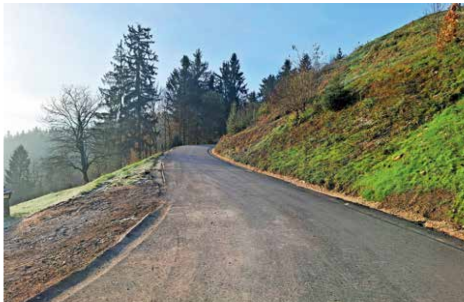
Na dostopni cesti iz Srednje vasi proti Dolenjemu Brdu še vedno poteka sanacija zaradi plazov poškodovane ceste. FOTO: ARHIV OBČINE
