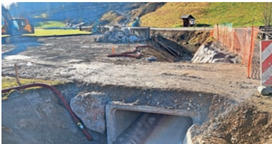
Občina je lani jeseni v okviru sanacije po poplavih začela sanacijo javnih poti na območju Podobena. FOTO: ARHIV OBČINE
