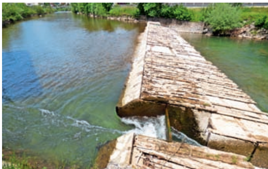
Pregrada ribje steze na jezov v Gorenji vasi je poškodovana in pušča, zato je nivo vode za jezom prenizek, kar slabo vpliva na ribe. FOTO: JURE FERLAN
