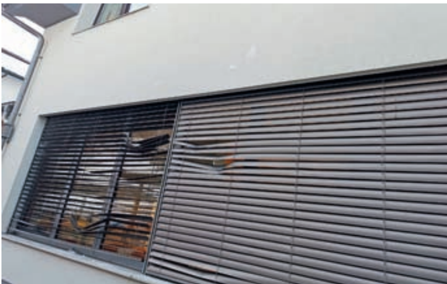
Z namernim poškodovanjem žaluzij na Osnovni šoli Poljane so vandali povzročili za tisoč evrov škode. FOTO: ARHIV ŠOLE
