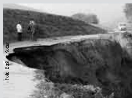
Lani je ob neurju plaz odnesel del ceste, ki so jo zato speljali tik nad plazom.
